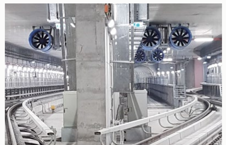
Tunnellüftungssystem für die Metro Doha
