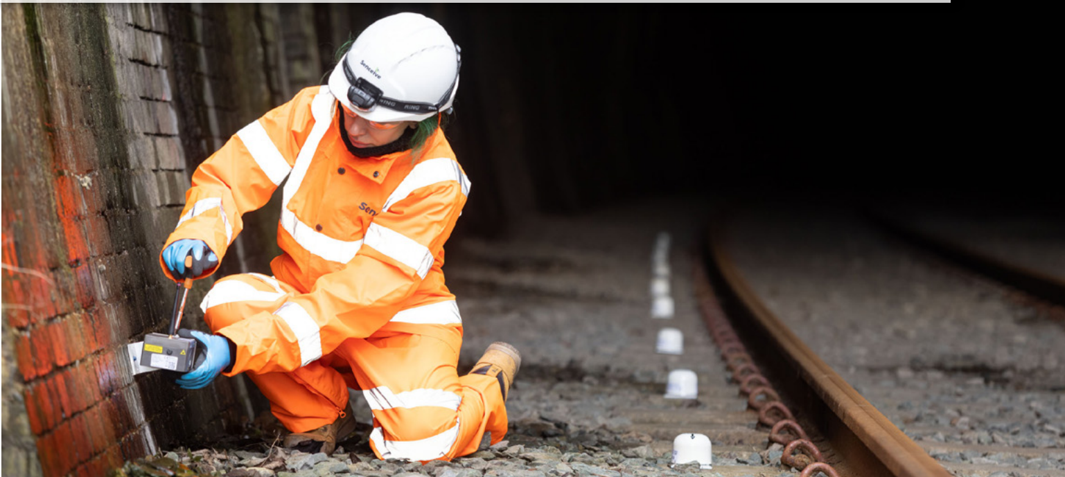
Sensoren zur Tunnelüberwachung
