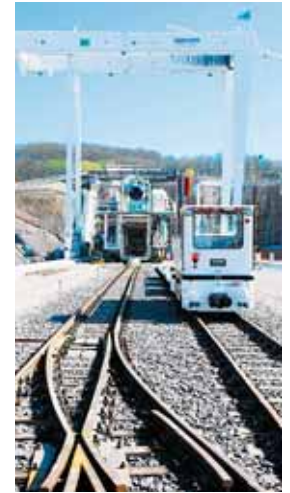
Vue du tunnelier avec la voie de desserte sur laquelle sont transportés la terre et les morceaux de roche.
